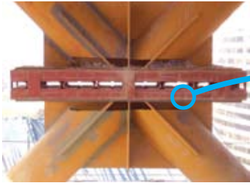
El rascacielos Titanium incorpora 13 disipadores de energía con el objetivo de reducir la demanda de deformación y esfuerzos, mediante el aumento del amortiguamiento estructural.
